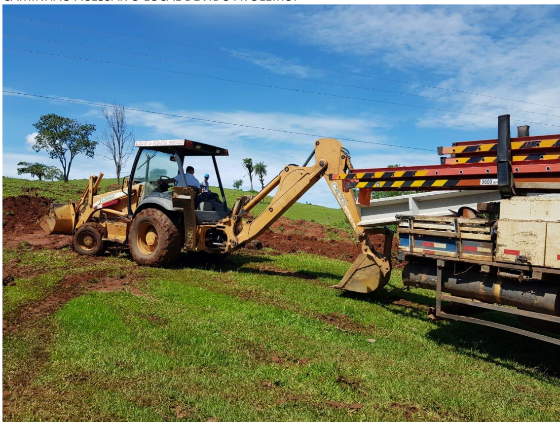
ATOLEIRO RODOVIA IPORÁ/IVOLANDIA, INTERDITADA, FOTO TIRADA EM 18/03/2019
