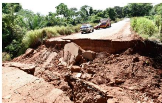
Local na GO-060 onde bueiro desabou após forte chuva em Israelândia — Foto: Octacílio Queiroz/Governo de Goiás
