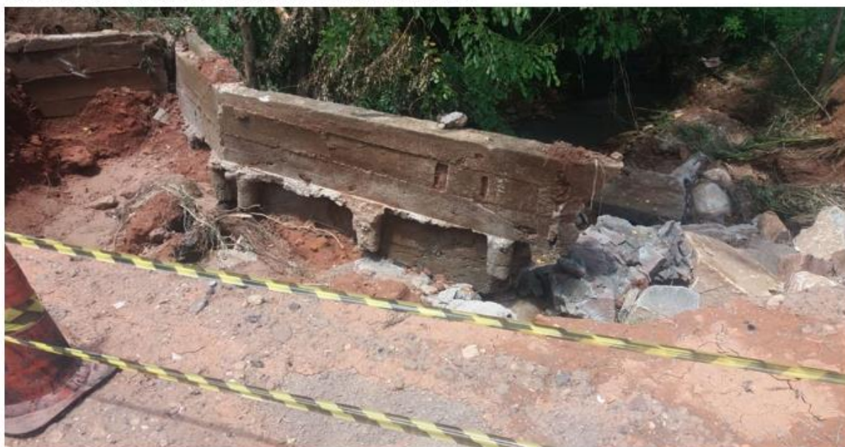
CHUVA EM PIRANHAS DESTRUIU BUEIRO 23/02/19
