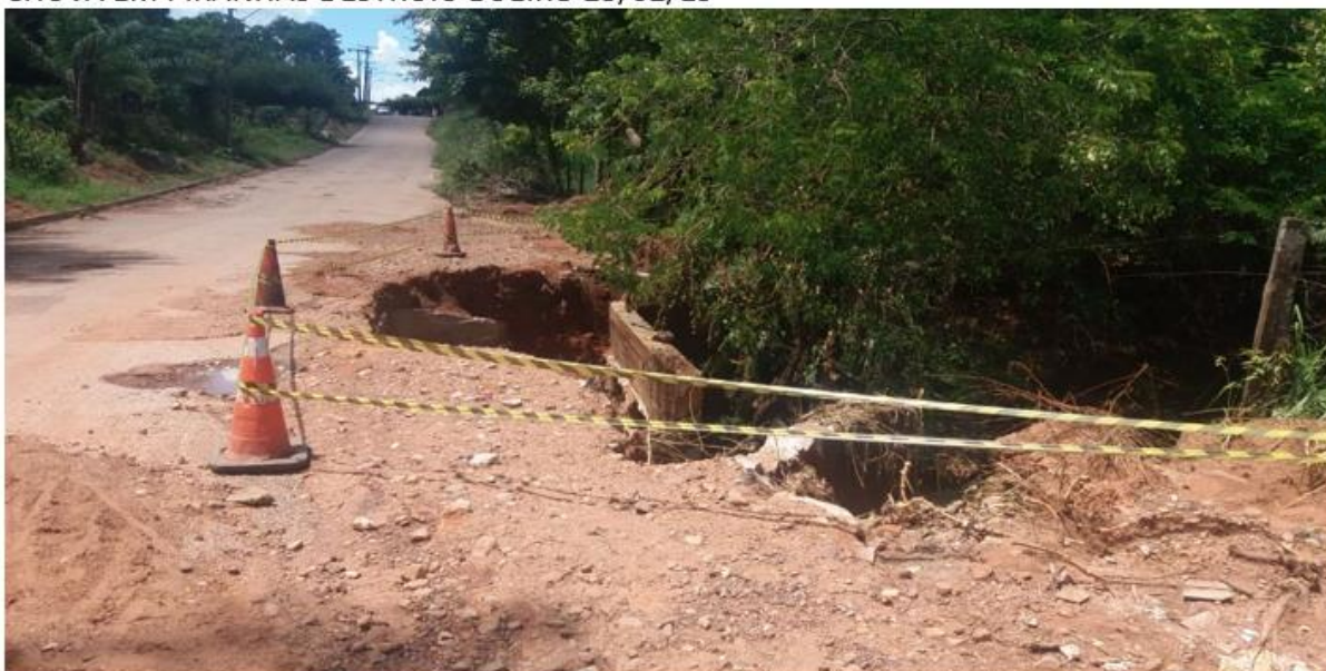
CHUVA EM PIRANHAS DESTRUIU BUEIRO 23/02/19
