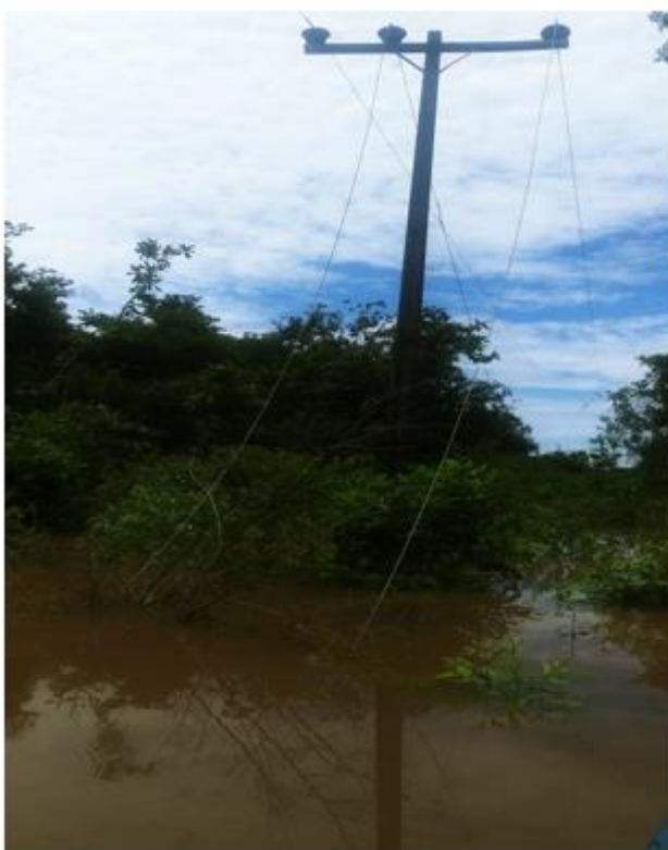
Alimentador -33 S/E 320(ARUANÃ TRANSMISSÃO) alagamento de rede em 06/03/2019
