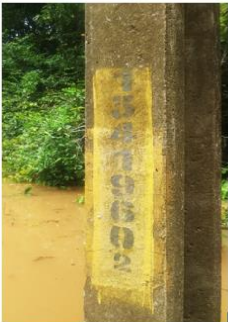
Alimentador -33 S/E 320(ARUANÃ TRANSMISSÃO) alagamento de rede em 06/03/2019
