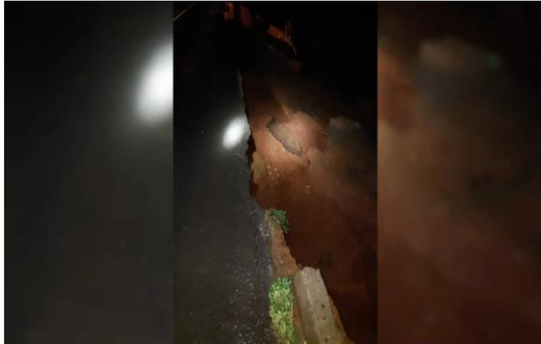
Chuva abre cratera e provoca interdição parcial da BR-153 em Morrinhos
