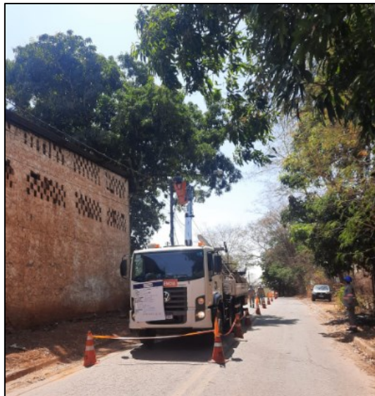
Evento: Cabo partido e Poste queimado Causa: Fogo sob a rede elétrica Fotos tiradas no local do evento no dia 30/08/2022
