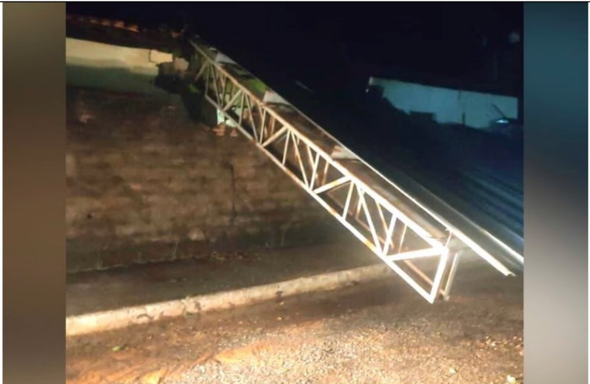
Estrutura de estádio desaba em residência após forte chuva, em Avelinópolis (Foto: Leitor - Mais Goiás)
