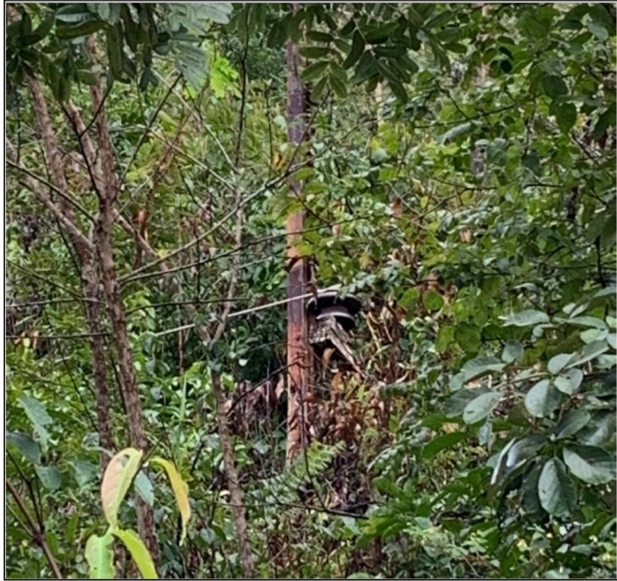
Defeito causado pelas fortes chuvas/ventos em Professor Jamil dia 13/04/2022.
