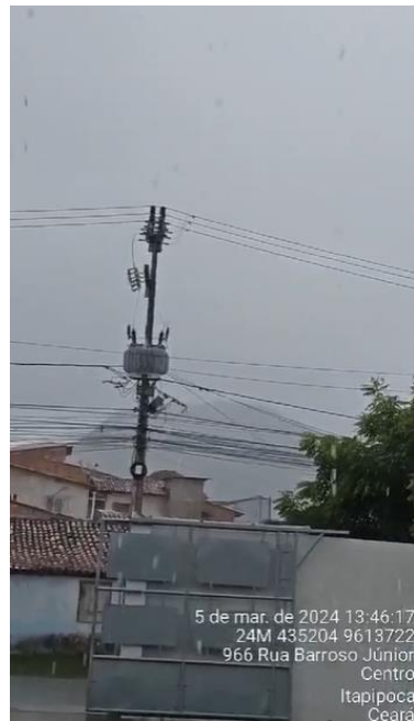
Figura 8. Foto registrada no dia 05/03//24 às 13:46 na localidade Itapipoca.
