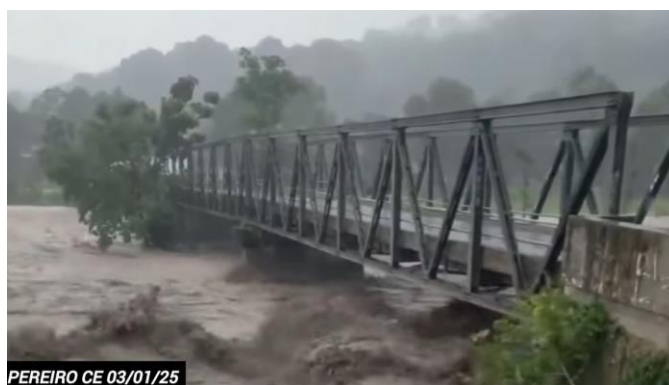
Figura 8. Foto registrada no dia 03/01/25 na localidade Pereiro.
