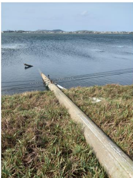
Poste tombado - 12/08/24 POC09 – Cabo Frio
