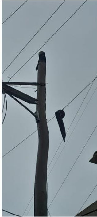
Estrutura quebrada – 26/08/24 Incidência 23582889
