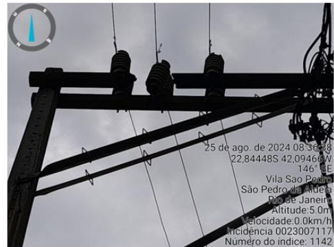
Isolador deu passagem para cruzeta 25/08/24 Incidência 23007117 – São Pedro
