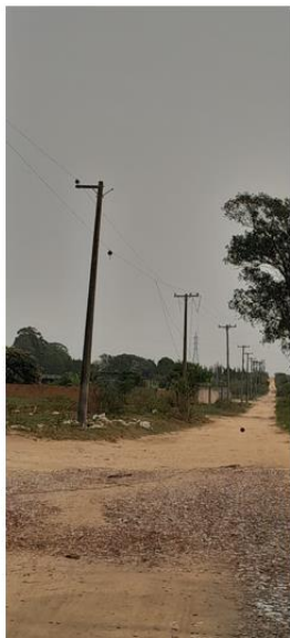
MT partida e estrutura quebrada – 25/08/24
