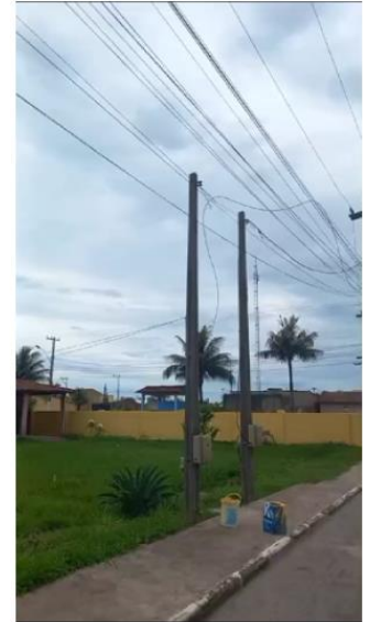
Condutor partido - 21/12/2024 Entrada Cond. Bouganville 01
