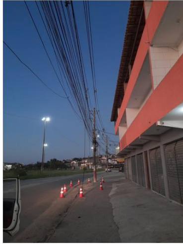
19/01/25 Condutores partidos Desarme POC02
